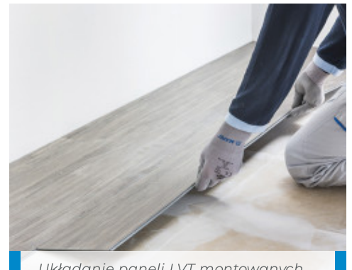
Układanie paneli LVT montowanych na klik na posadzce ceramicznej wyrównanej z użyciem Planiprep 4 LVT
