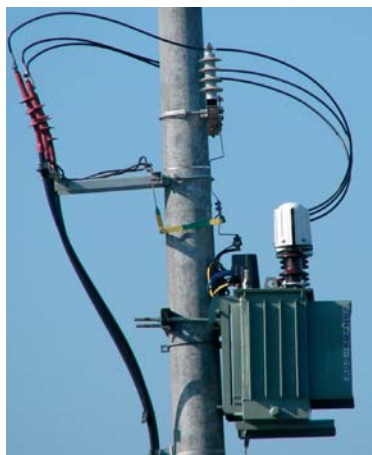
zabezpieczenie uproszczonej stacji transformatorowej 15/0,4 kV
