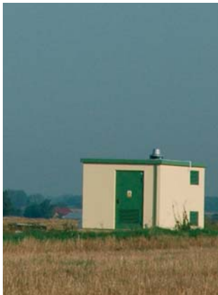
stacja transformatorowa 15/0,4 kV
