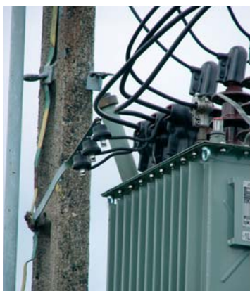
początek linii napowietrznej nn
