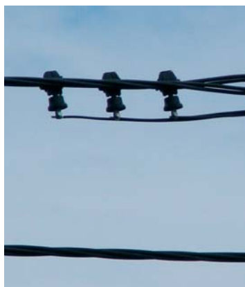
linia główna 1 komplet ASA co 500 m
