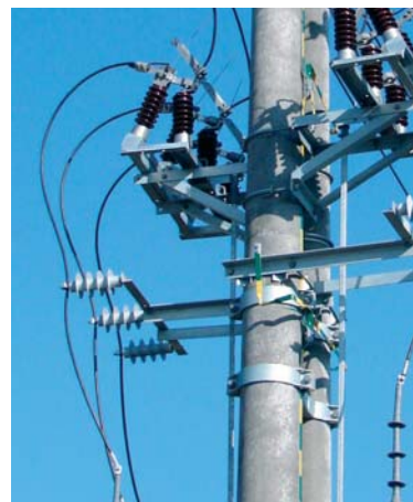
zabezpieczenie kabla SN – zejście z linii napowietrznej
